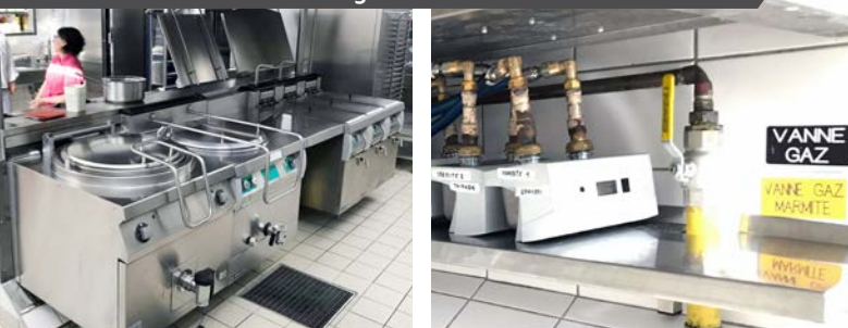
Instalación del contador de gas en una cocina de un centro escolar.
